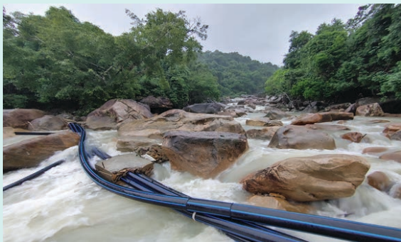
Đường ống qua suối lúc chưa hư
